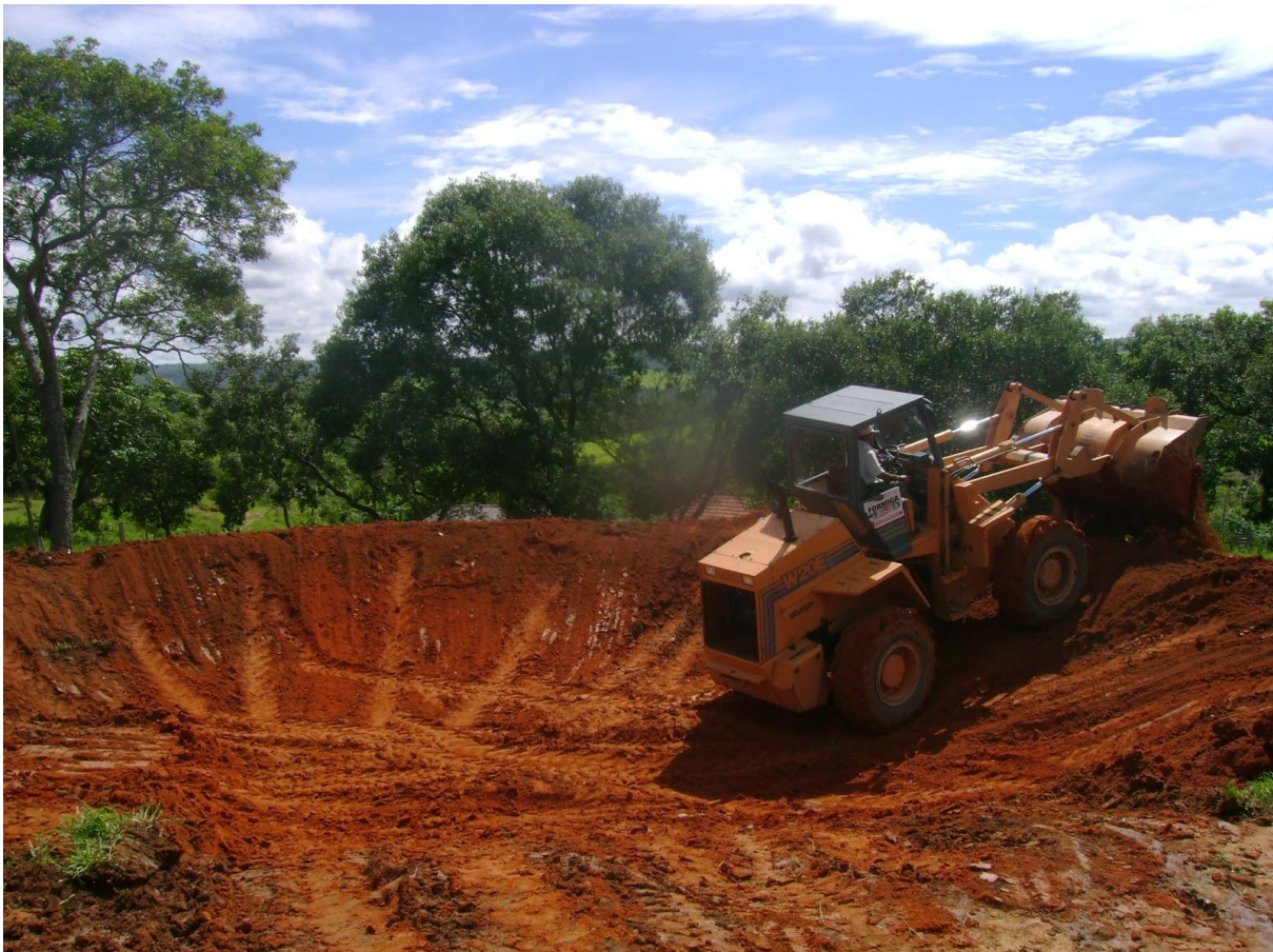
Figura 8: Pá-carregadeira durante a construção de uma bacia de captação de água pluvial
