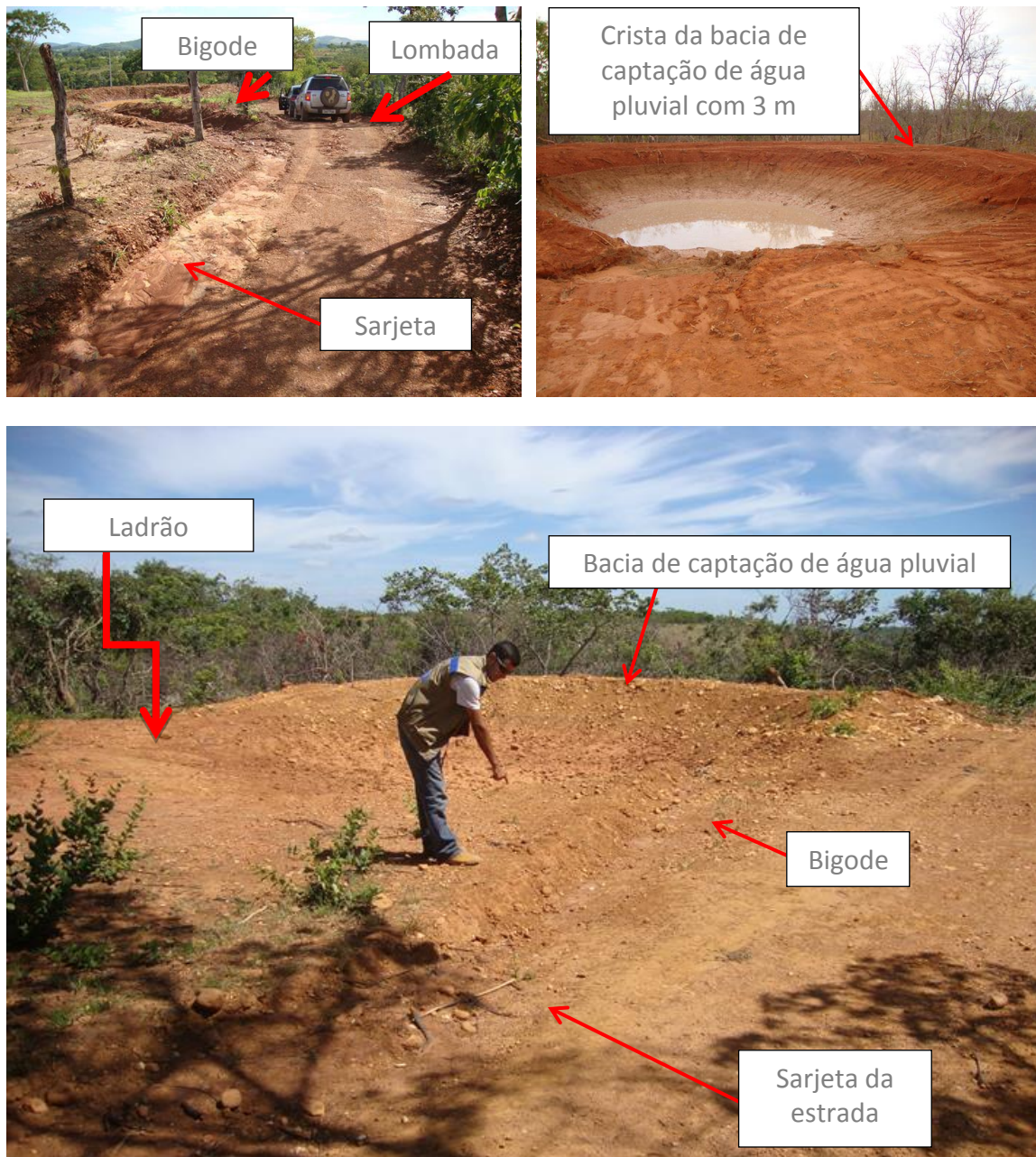
Figura 9: Bacias de captação de águas pluviais para coleta de enxurrada gerada em estrada rural
